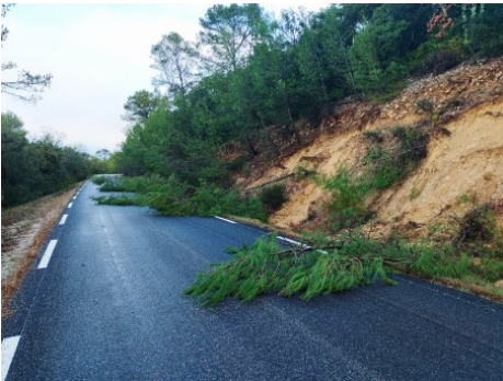
Dégâts sur route départementale D218
